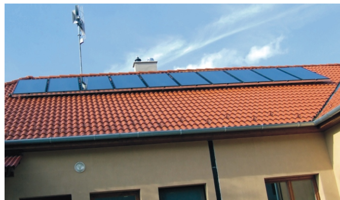
Napkollektorok a Gondozási Központ tetején
